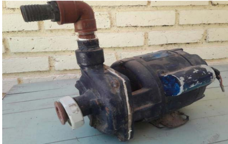
Figura 3. Sistema de bombeo.
