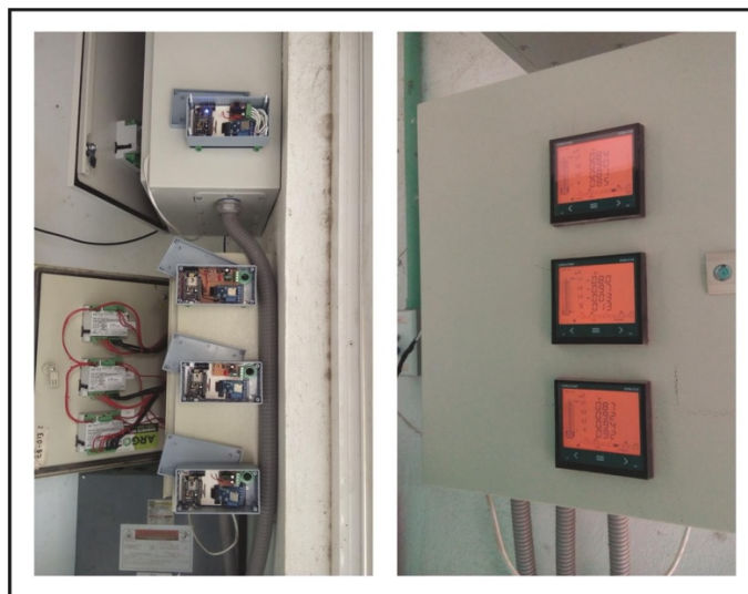
Figura 10 Equipos instalados en la industria
