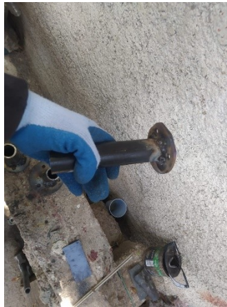
Figura 8 separación entre soldadura
