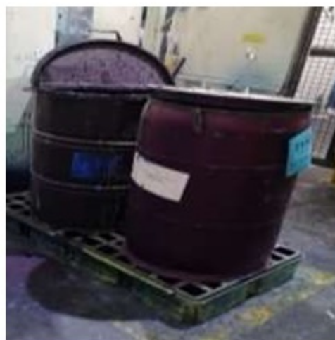
Figura 12: químicos con etiquetado y dentro de la tarima de contención.
