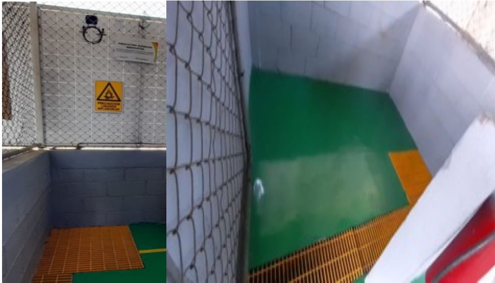
Imagen 3. Rejillas antiderrames y fosa de retención.
